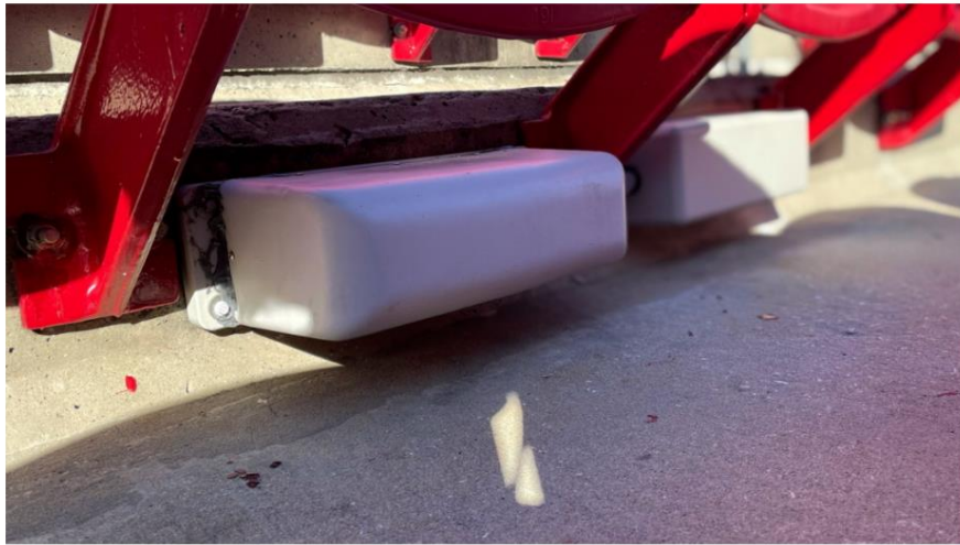
スタジアムのシートの下に設置された5Gミリ波のsmallセル
