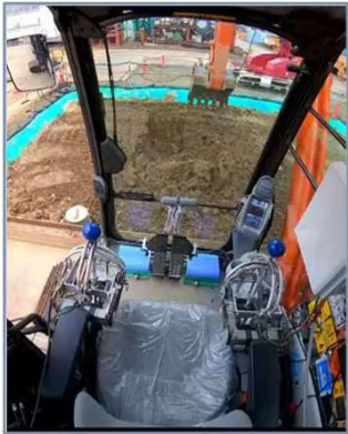
ロボット化した操作室
